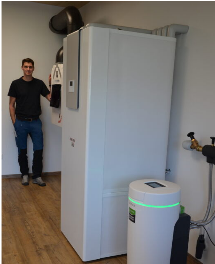
Rudi Kreuzeder im Vorführraum für Sanitär- und Heizungstechnik. Die hier verbauten Geräte sind alle im Firmengebäude im Einsatz.
